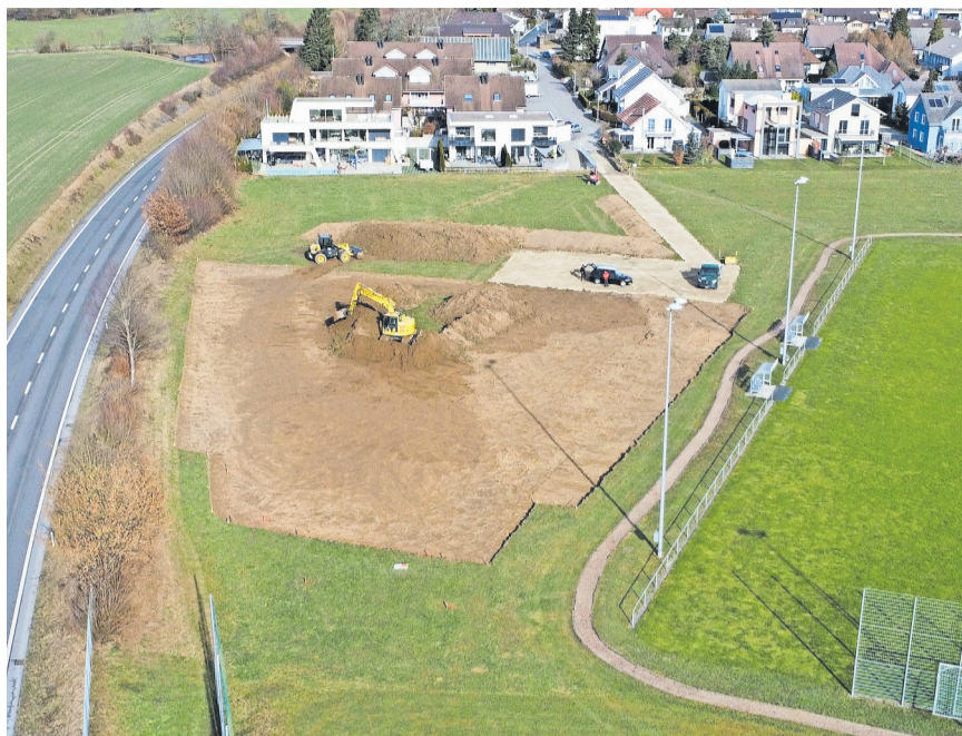
Die Firma A. Meier Tiefbau aus Hirschthal hat bereits mit dem Abtragen des Oberbodens begonnen. BILDER: ZVG
